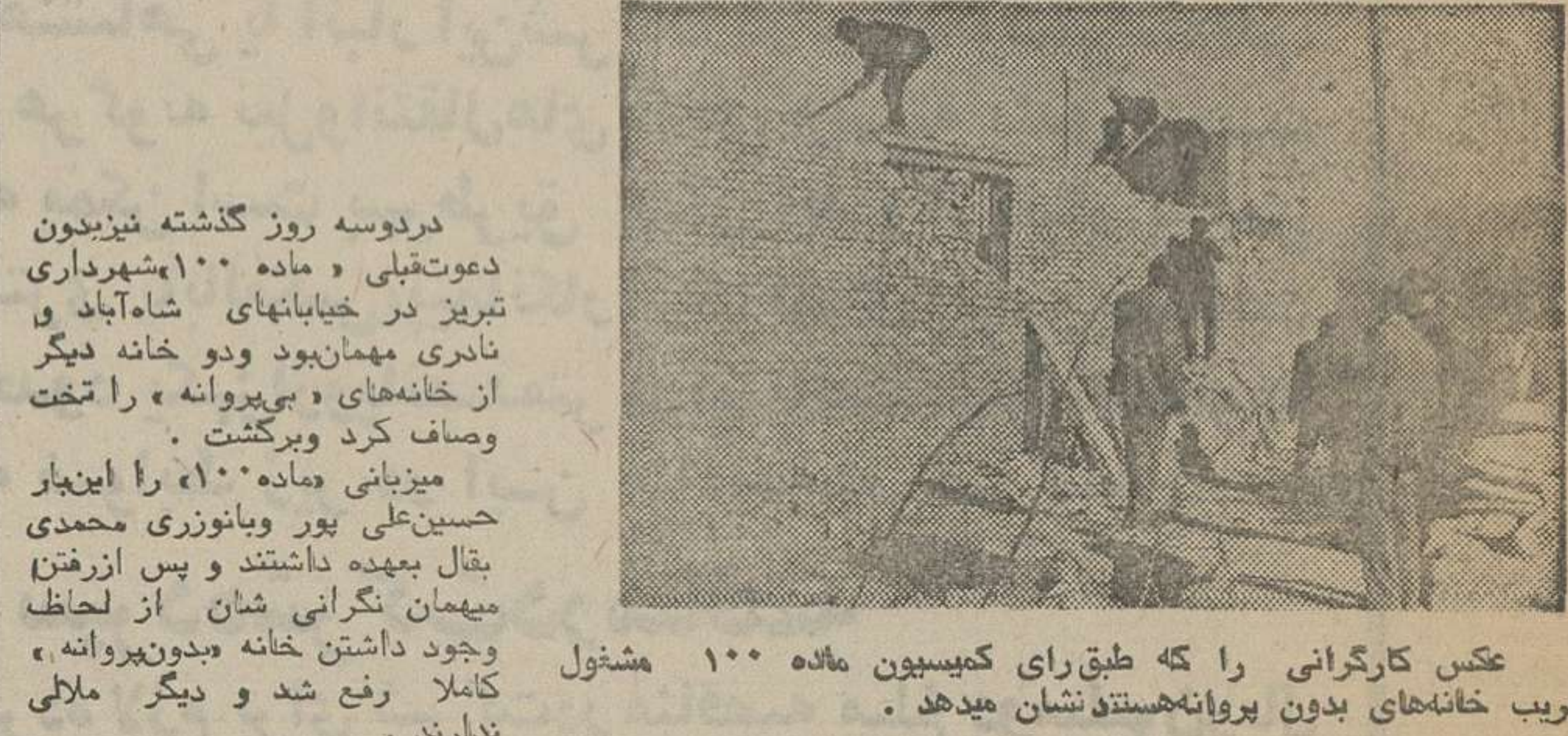
عکس کارگرنانی را که طبق رای کمیسیون ماده ۱۰۰ مشغول تخریب خانه‌های بدون پروانه هستند نشان میدهد .
