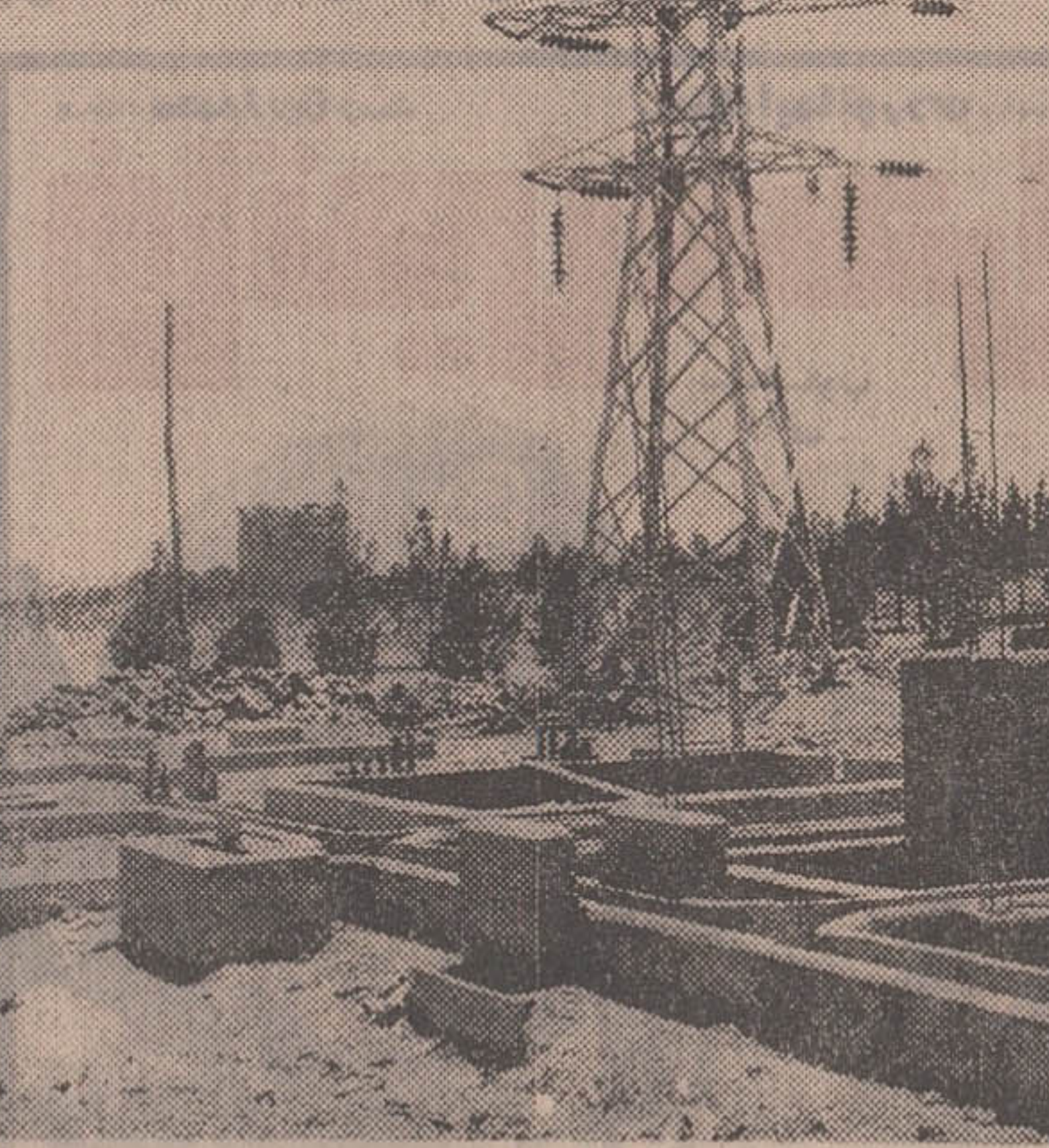
برق انتقال نیروی برق باولتاژ ۶۲ هزار ولت در اصفهان
